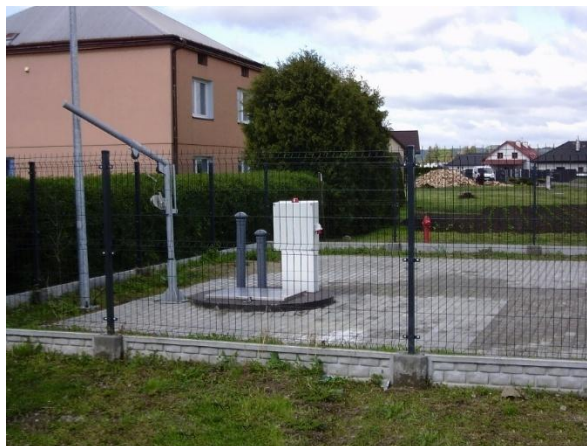
Fot. 1 źródło własne – Pompownia w miejscowości Krówniki
