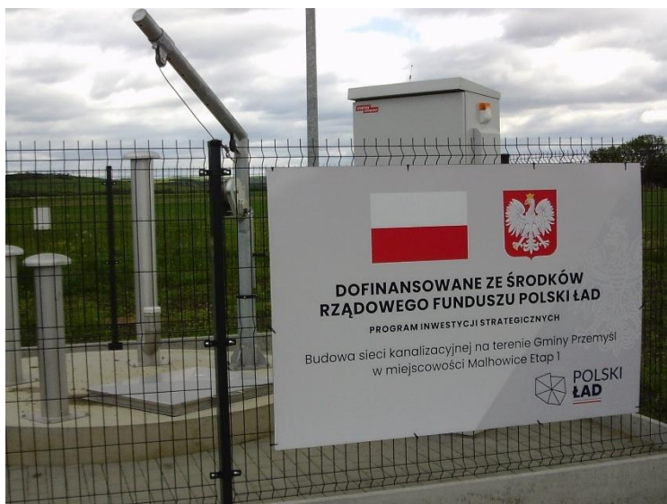
Fot. 1 źródło własne – Tłocznia ścieków w miejscowości Malhowice
